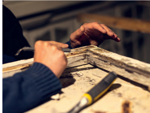
Råte. Foto: Bård Gundersen / Fortidsminneforeningen
