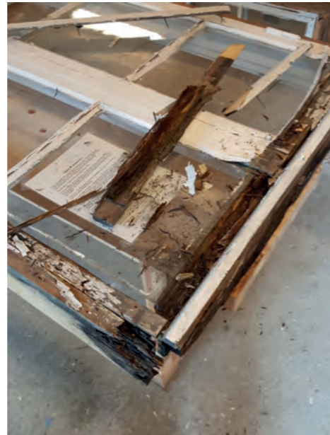
Dette er et eksempel på råteskader som må repareres. Foto: Ellev Steinsli
