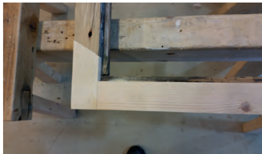
Dette er et eksempel på hvordan treverk er spunnet inn. Foto: Ellev Steinsli
