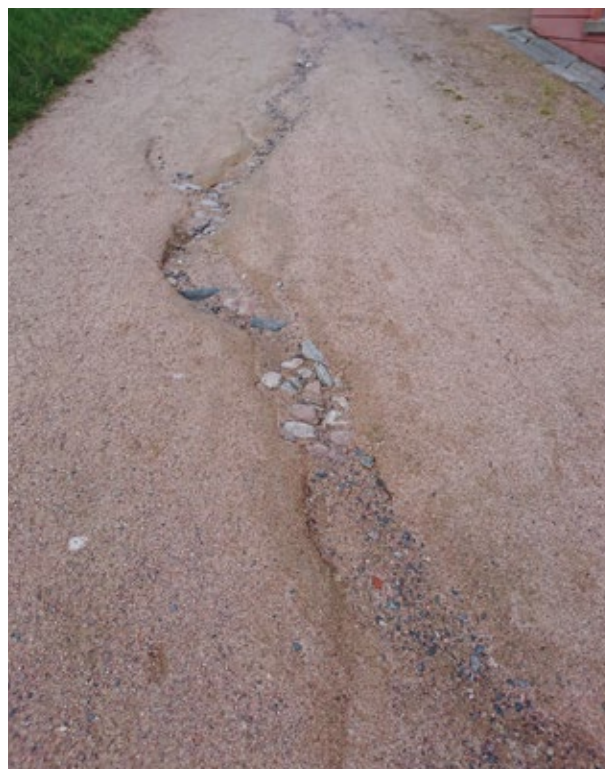
En rännil av regn har blottlagt underbyggnaden av kullersten från 1700-talet vid en vägbyggnad som inte har en fungerande ytvattenhantering. Tung trafik har gjort spår i vägbanan, vilket lett till att vattnet inte rinner mot sidorna utan i mitten av vägen. Längs den vänstra sidan saknas rännal helt, medan den på den högra sidan ligger för högt i förhållande till vägbanan. Foto: Joakim Seiler.
