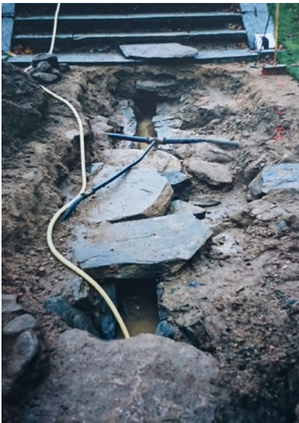
Norra formella trädgården på Gunnebo slott. Under gångarna ligger stenlagda dräneringar som via den centralkulvert som syns på bilden leds ut till ett vattendrag. Foto: Inger Ernstsson.
