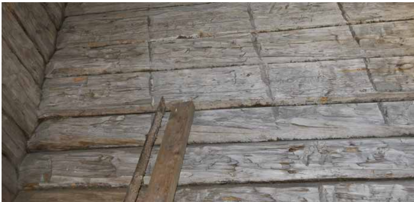
Figur 7.14. "Salsdelen" av byggnaden blev aldrig färdigställd. Här syns hur inhuggen i stockarna följer ovanför varandra och är gjorda på plats för det antal stockar som bör motsvaras av ett bomlag. (Men vi fann inga spår av invändig ställning av den typ som har borrats in i väggen med grova navare.) Att stockarna ovanför är finare bilade är också en normal del i arbetsprocessen så som den beskrivs i uppteckningar: man finbilar färdigt de tre-fyra översta varven innan man lägger tak annars kommer detta att bli onödigt trångt och arbetsamt att bila till en fin yta.
