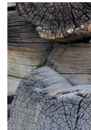
Figur 7.24. Falsen i stock A2 vid knuten AB. Falsen hindrar den undre stocken B1 från att glida utåt. Samma iakttagelser gjordes i stocken ovanför dörröppningen där den har haft samma låsande funktion. Falsen fanns även i A-väggens stock ovanför dörren i ett annat, liknande härbre på hembygdsgrden.
