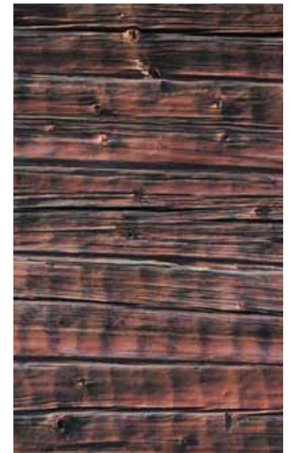
Figur 7.18. Härbret har så släta väggar att de grunda såtarna nästan får konkurrens av märgsprickor i stockarna. Finbilningen av stockarna är typiskt för trakten och tiden. Notera att det är gjort på väggen, att timmerhantverkaren låter yxan gå närmast lodrätt och ner över nästa varv.
