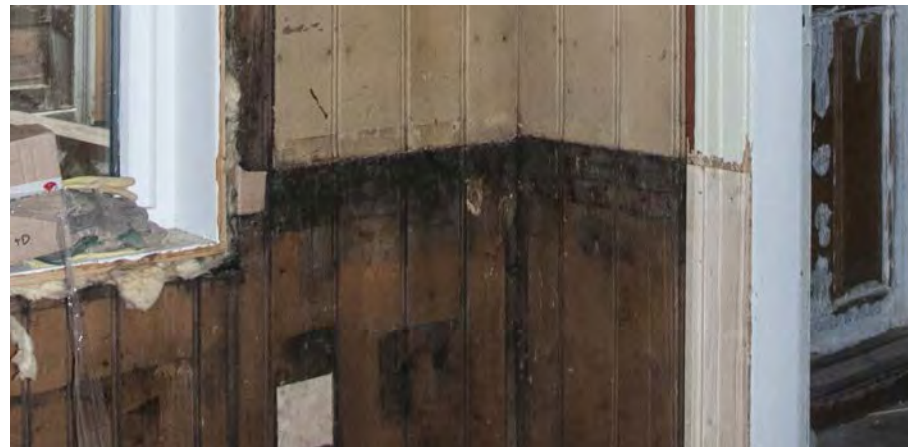
Skader og reparasjoner av vegg og karm. Husk at hvordan skader i overflaten repareres også har påvirkning på sluttresultatet.
