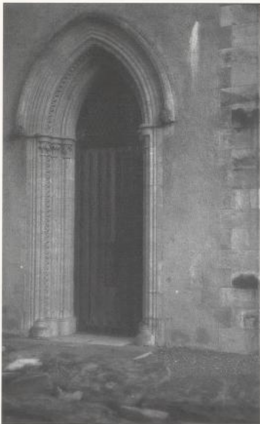
Den gotiske vestportalen i tårnet til Ullensvang kirke. Portalen sto opprinnelig i vestgavlen til middelalderkirken. Hjørnesteinene er fra Kvitno – de mørke feltene i noen av dem er rust-utfelling.
