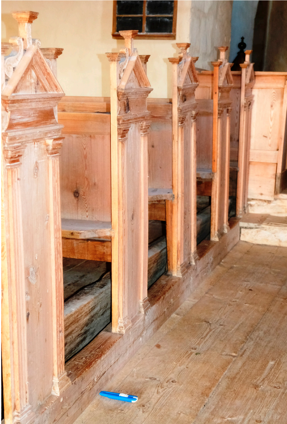
Fig.21. Gulvbordet som er datert sees under benkene på nordsiden av skipet. Det er andre bord fra benkestokken og prøven er tatt av de ytre årringene innenfor kniven. Innhugg under gulvbordet viser at bjelkene som ligger rett på jorda har vært byttet om minst en gang. Bare ett bord er datert, men de andre bordene i skipet har samme karakter; brede halvkloyvinger. Foto: Morten Stige
