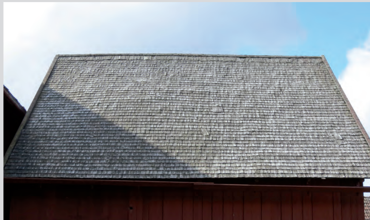
Figur 3.17. Taket före omläggning. Lägg märke till att taket har lappats mitt på taket.
