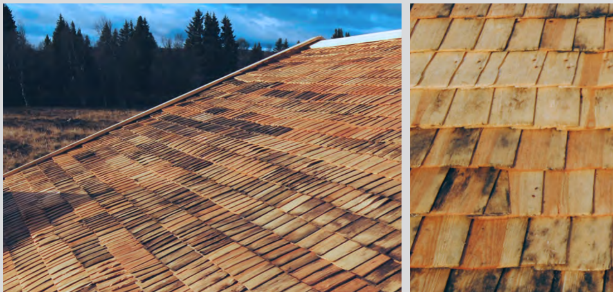
Figur 8.2. och 8.3. Det nya taket av stickspån som redan från början var angripet av blånadsvamp och där undermåliga spån inte sorterats bort utan spikats upp på taket.
