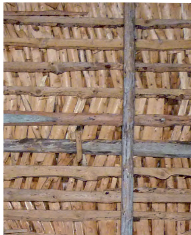
Figur 3.2. Underlagstak där sekundaspån lagts snett för att bära upp den egentliga spåntäckningen.
