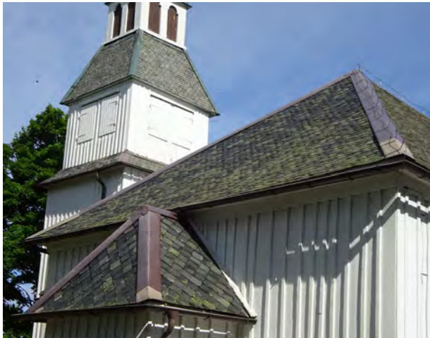
Figur 39. Överdimensionerad plåttäckning på Gesäter kyrka i Dals-Eds kommun, Dalsland. Jämför med fotografiet till höger. Foto: Takskifferprojektet i Karlstads stift.
