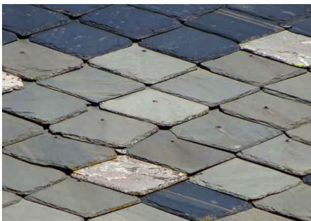
Figur 13. Här har ett takfall kompletterats med avvikande skiffertyper. Foto: Takskifferprojektet i Karlstads stift.
