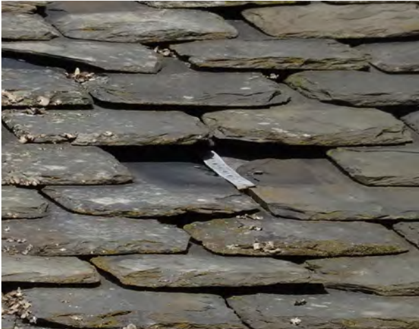
Figur 23. Äldre lagning med plåtband som gått av och skifferplattor som lossnat. Foto: Takskifferprojektet i Karlstads stift.
