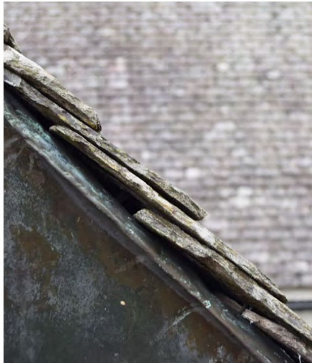
Figur 10. Skiffertak sett från sidan. Täckning med 2-3 lager på Gunnarskogs kyrka i Arvika kommun. Foto: Takskifferprojektet i Karlstads stift.
