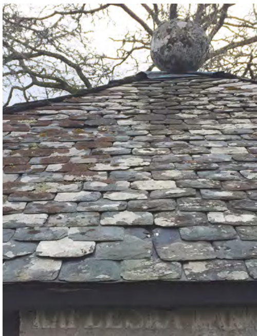
Figur 38. Skifferplattor som saknas på taket till Kafleska familjegraven vid Steneby kyrka i Bengtfors kommun, Norra Dalsland. Foto: Taksifferprojektet i Karlstads stift.
