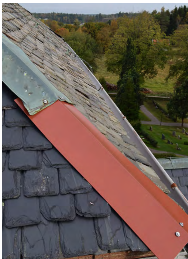
Figur 34. Här brister takarbetet i flera avseenden med negativa konsekvenser både för den tekniska funktionen såväl som estetiskt. Foto: Takskifferprojektet i Karlstads stift.
