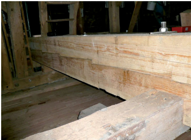
Bild 7 Neu hergestellter Ersatzbalken aus dem Jahre 2008 (Holzart Kiefer) New duplicated substitute composite beam made in 2008 (type of wood: pine)
