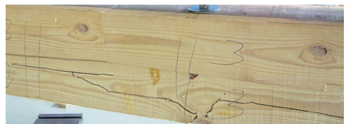
Bild 21 Zahnbalken Nr. 3 – Bruch durch Ast im Zugbereich (Trägermitte) Composite beam No. 3 – breakage through branch in the tension area (middle of the beam)
