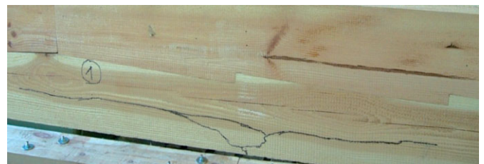
Bild 17 Zahnbalken Nr. 1 – Horizontalriss Composite beam No. 1 – horizontal crack
