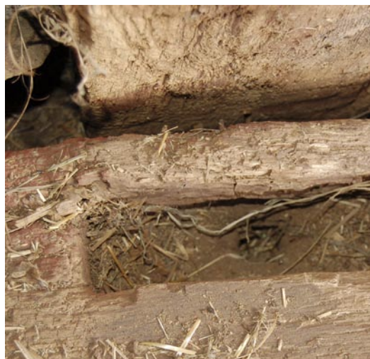
FIGUR 12. En anmärkningsvärd detalj är de borrade hål genom långsidornas syllar som finns i botten av tapphål. Sådana har påträffats i flera tapphål på östra långsidan där syllen är frilagd. Hålen visar att timmermännen varit medvetna om de rötangrepp som kan uppstå i tapphål om dessa blir vattenfyllda. Detta har de här löst genom särskilda dräneringshål, en metod som också används i bygghantverksprogrammet vid institutionen för Kulturvård i Mariestad, men som inte har påträffats tidigare i byggnadsundersökningar. Foto Ulrik Hjort Lassen.
