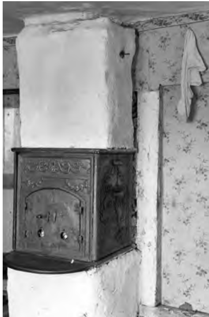
VINDUGN I HEMMINGSMÅLA, JÄMSHÖGS SOCKEN, BLEKINGE. Skillnaden mellan vindugnen och sättugnen är att den senare eldas från en gruva. Vindugnen har ugnsluckor och egen rökgång. I detta exempel är rökgången murad och putsad. FOTO BLEKINGE MUSEUM.
