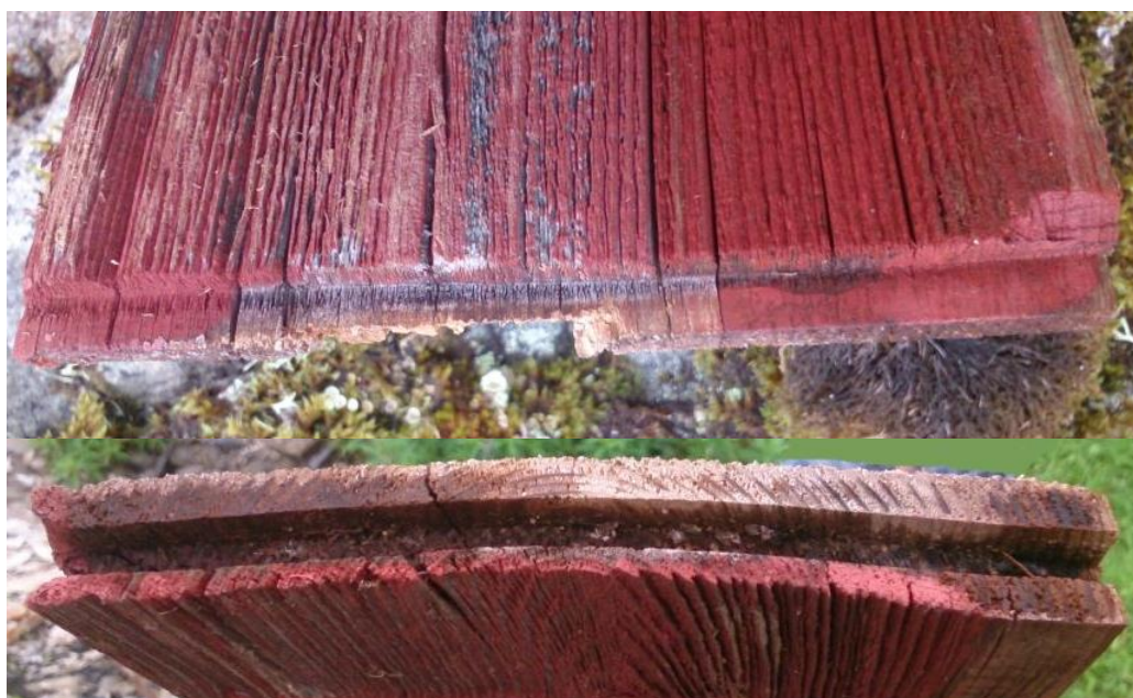
Figur 61: Pennen i høgre ende. Legg merke til avfasinga til høgre i det øvre biletet. Ser ut som om bordenden er støthøvla og at det er utriving i nedre kant av notsporet som er til venstre i det nedste biletet. Kledning frå Ulvik. Fotograf: Odd Gunnar Hauge
