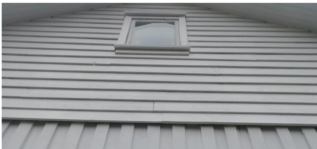
Figur 65: Det er berre den liggande kledningen i gavlane, under glasa, som er skøyta og me finn endepløying. Om lag 16 skøytar totalt. Kledning på Bakka.
