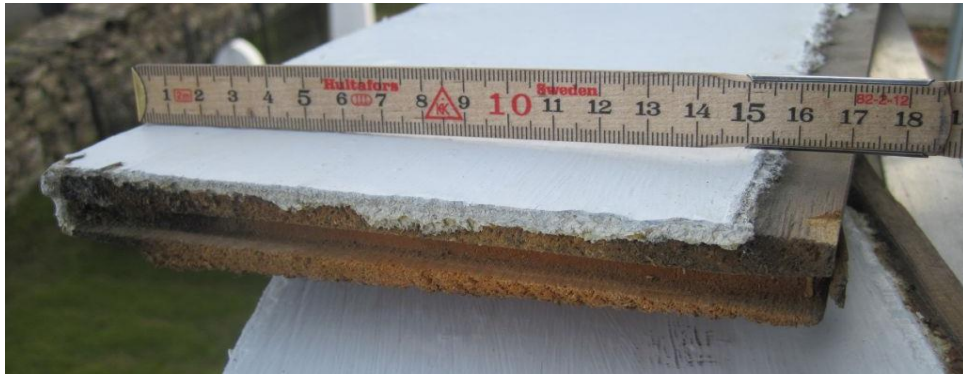
Figur 49: Døme på not i høgre ende med utrivning oppe. Frå kledningen på Sand kyrkje.
