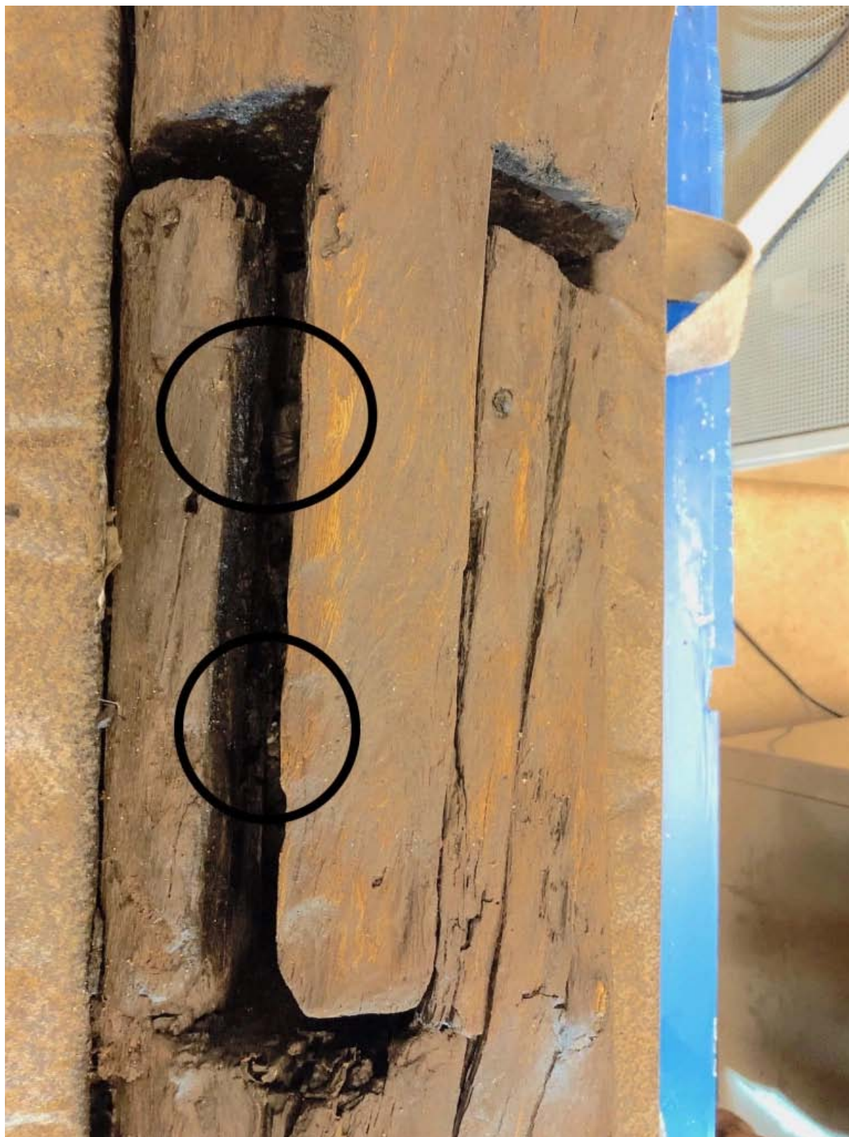
Bladskjøten sett ovenfra , den var plagget med to treplugger. Lyset på bildet er litt manipulert for å få
