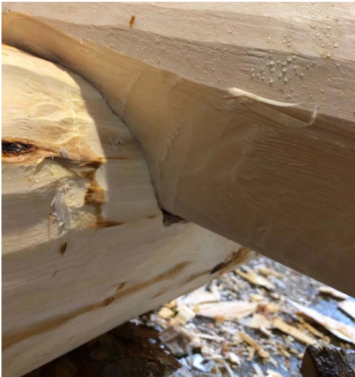
Ferdig i vegg nova ble tett. Foto Kai Johansen
